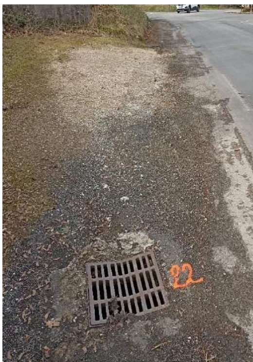
Figure 14. Grille de collecte - réseau EPI Avenue du Général de Gaulle
