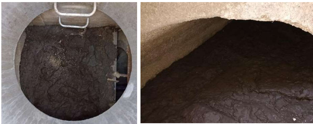
Figure 27 : Photo anomalie 8 – Comblement par sciures de bois
