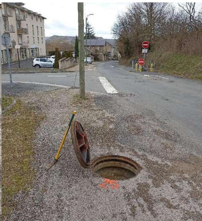
Figure 15. Regard - réseau EP Avenue Général de Gaulle
