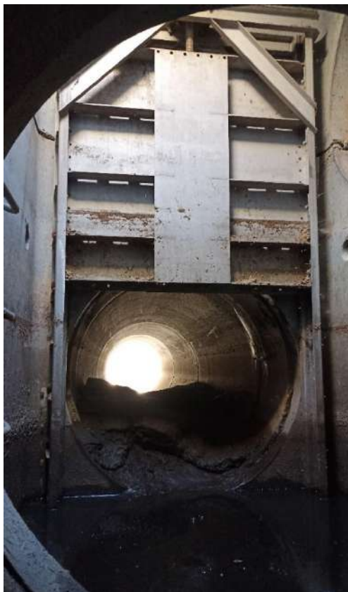
Figure 19 : Vanne bassin de rétention Cogra
