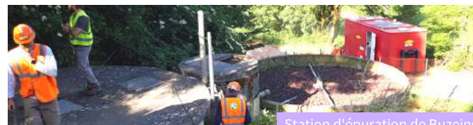
Station d'épuration de Buzeins
